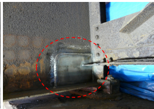
溶接による当て板補修の例
