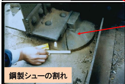
シュー座の破損
